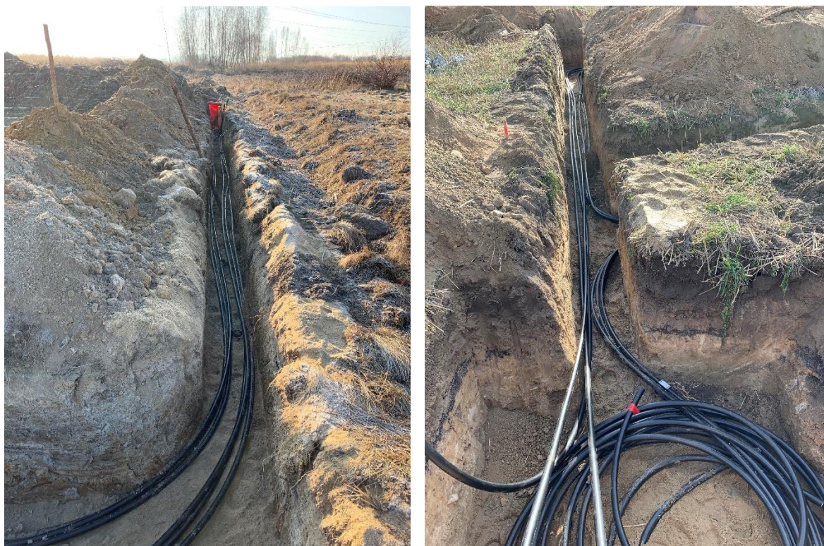
Zdjęcie 4 Przykładowa realizacja okablowania farmy - odpowiednio kable niskiego i średniego napięcia
